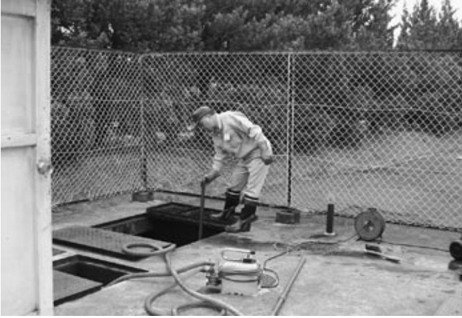
公共施設の浄化槽定期点検
