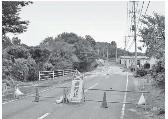
現在も通行止めが続く市道(糖沢地内)
