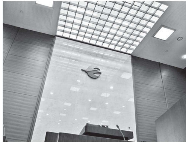
市庁舎内に設置されたLED照明
