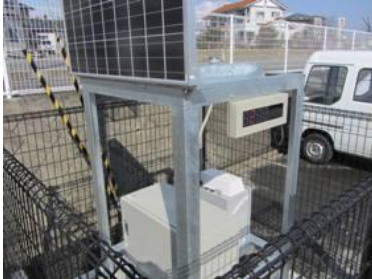
モニタリングポスト (電離箱方式) 本宮市役所
