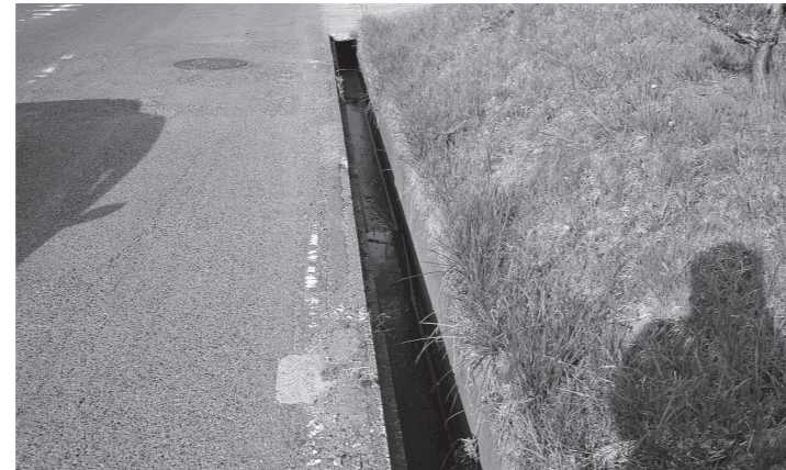
側溝内の土砂はまだ線量が高い
