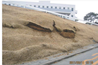
地震により敷地内も被害を受けた
