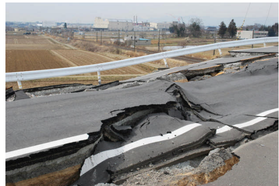
▲富士内・上沢線の被害状況(4月7日撮影)
