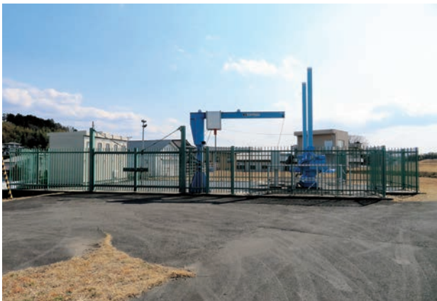
▲増強している戸崎排水ポンプ場 (高木字戸崎地内)
